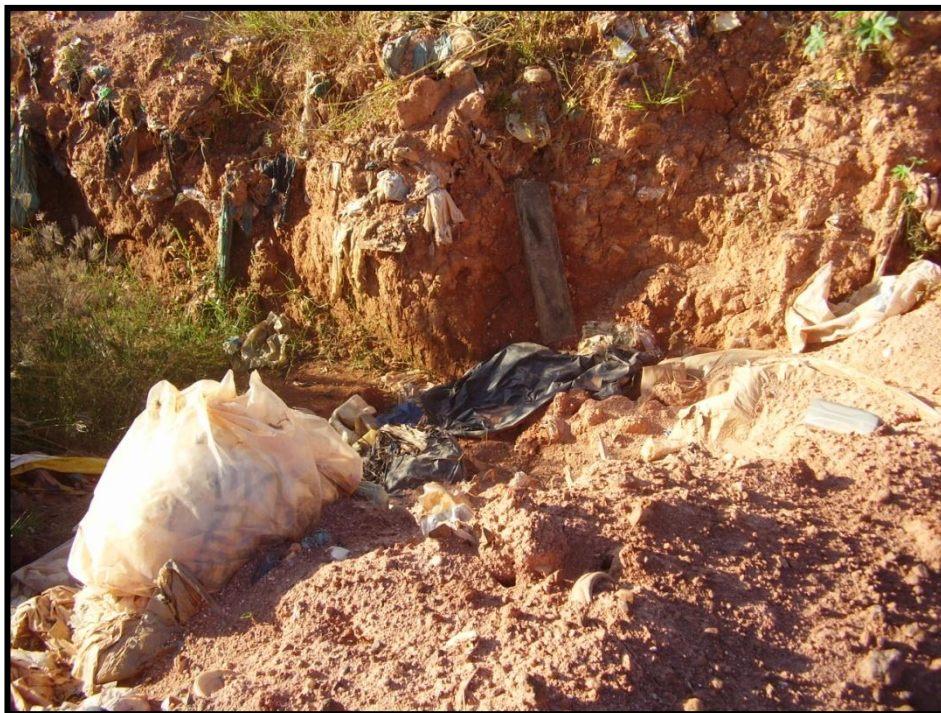
Figura 05: Processos erosivos provocados pelas águas das chuvas. Fonte: MESQUITA, Andréia Pereira (2010).
