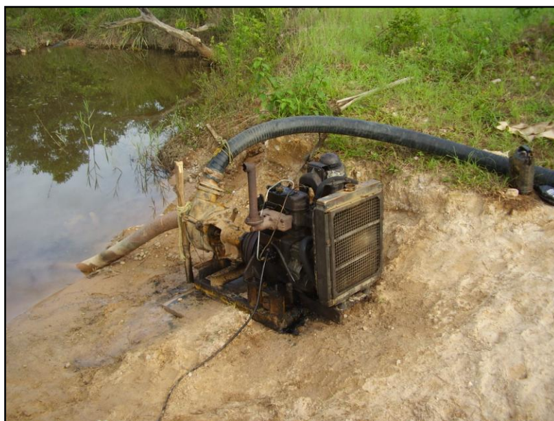
Figura 17. Bomba d'água, com pequeno vazamento de combustível. Fonte: LEMES, Denise Peralta (2009).
