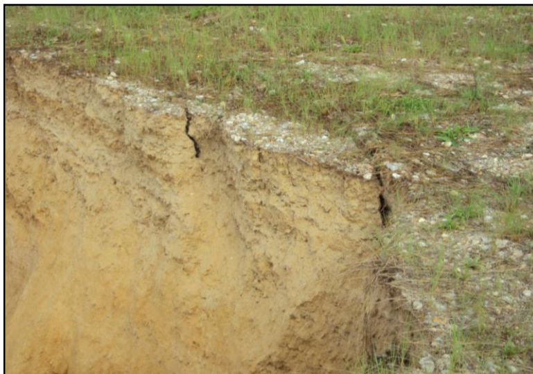
Figura 9. Processos erosivos a margem do rio Juininha. Fonte: BASTOS, Beatriz Regina Nunes Perrone (2009).
