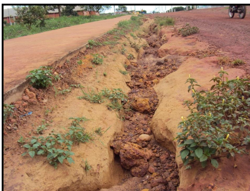
Fig. 12: Erosão em sulcos. Fonte: IZAC, 2010
