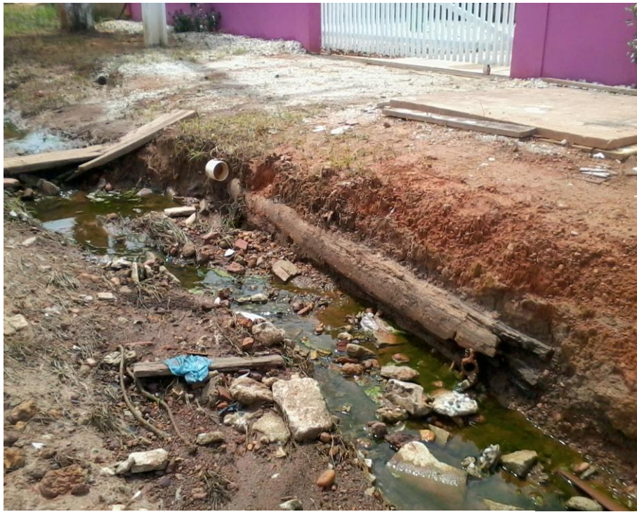
Figura 7: Esgoto da pia jogado na rua Fonte: CORDEIRO, Mirieli da Silva (2012).
