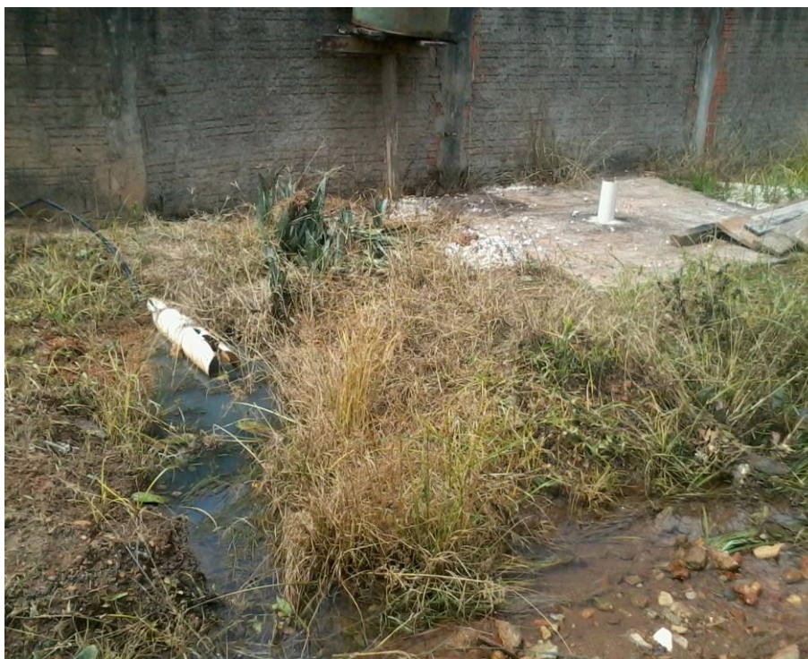
Figura 9: Fossa na frente da residência e o esgoto do tanque jogado na rua.
