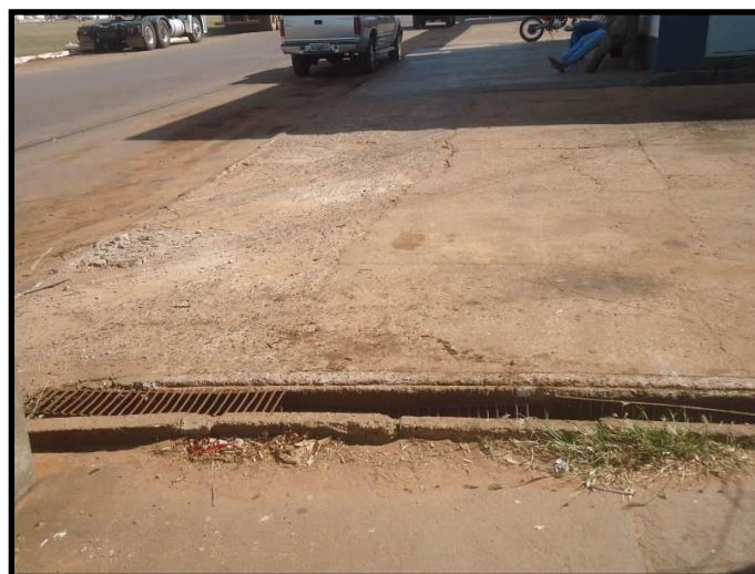
Figura 15: Adaptações Irregulares Av:JK (BR) Fonte: Figueiredo, (2013)
