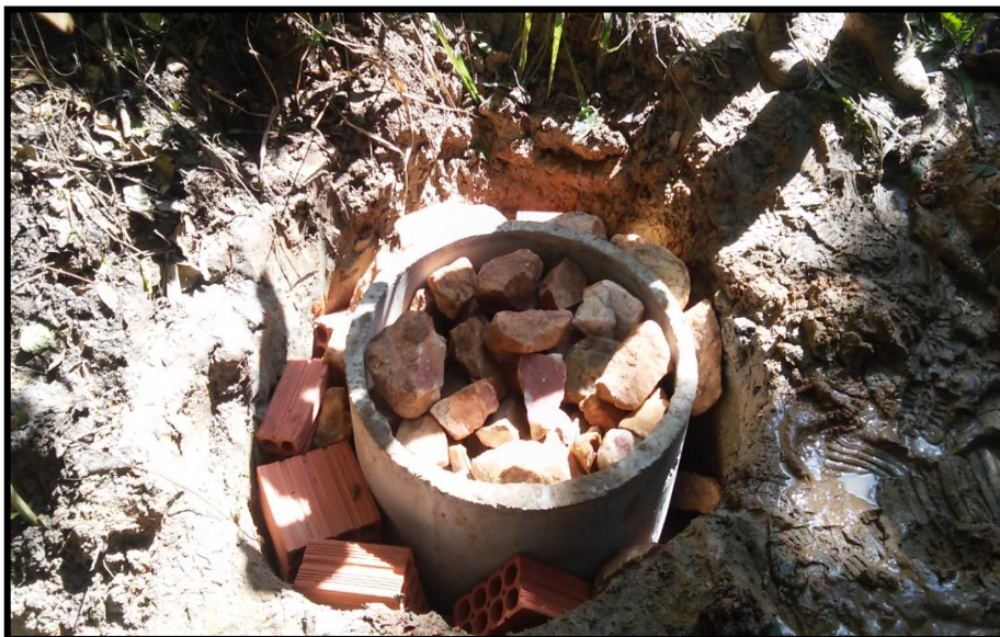
Figura 07: Construção de recipiente e reservatório com a manilha para proteção da nascente
